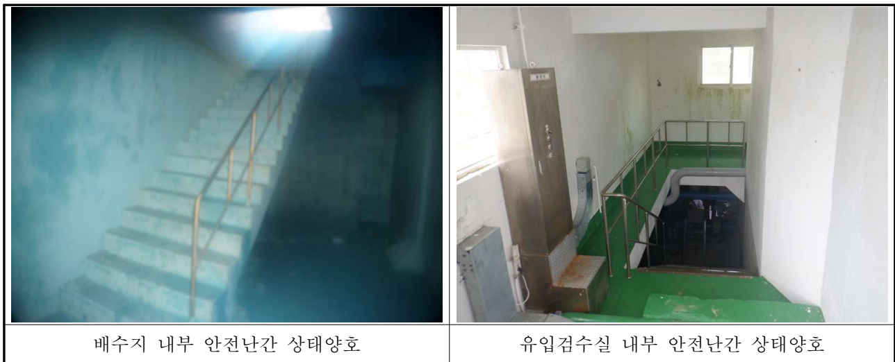
【사진 3.7】 안전시설(점검로) 손상사진
