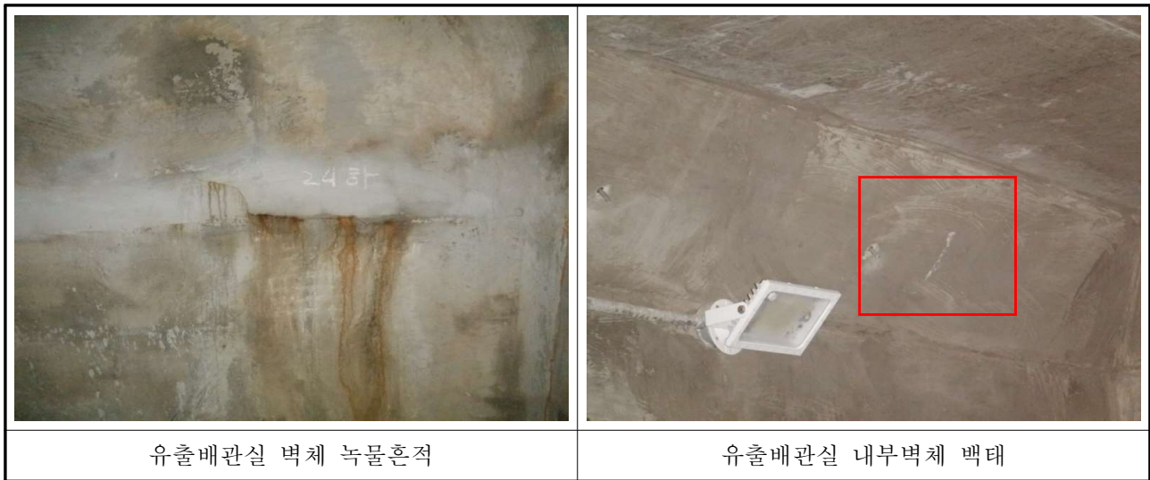
【사진 3.4】 유입·유출 배관실 손상사진 (계속)
