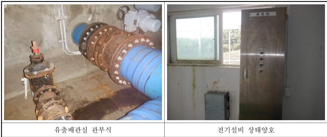
【사진 3.6】 기전설비 손상사진
